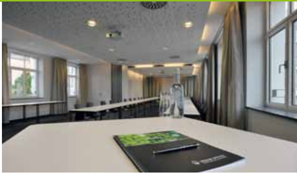
Im Konferenzraum befinden sich leistungsstarke Kanaleinbaugeräte in der Decke
